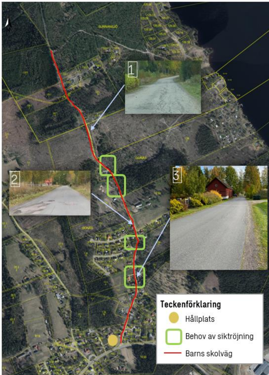
Figur 12: Brister efter Brittsandsvägen. Bild 1-2 illustrerar sprickbildningar och sättningar utmed vägen, bild 3 illustrerar fastigheter och vegetation nära vägen. Dedikerat utrymme för oskyddade trafikanter saknas. Bakgrundkarta: flygfoto © Lantmäteriet (2022).
